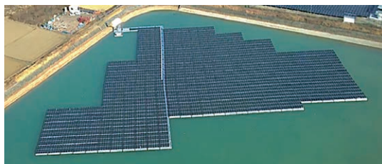
水上ソーラー設置例：貯水池発電所（兵庫県三木市） 当該ソーラーの面積：9,500㎡
