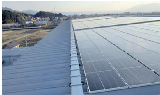
再生可能エネルギー活用事例 (天理事業所の工場建屋上の太陽光発電設備)
